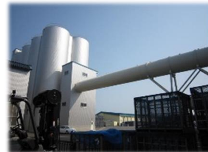
乾燥調整施設
